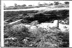
Se observa el canal bajo, siendo este el punto de descarga final de las aguas pluviales del Fraccionamiento San Jacinto
